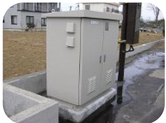
給水水質自動監視装置
