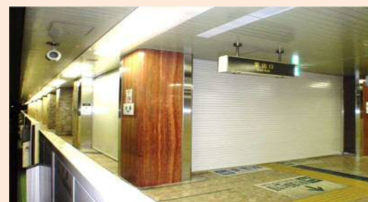
〈 防火シャッター 〉
