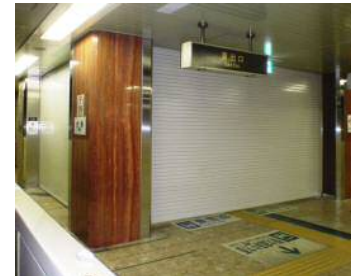
《ホーム階の防火シャッター》
