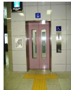
< 新設エレベーター >
