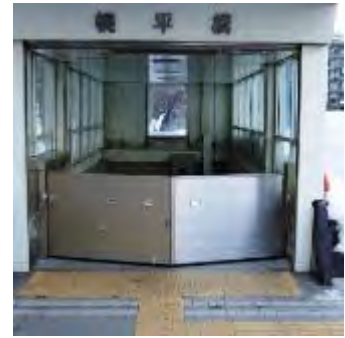
南北線 幌平橋駅 止水板
