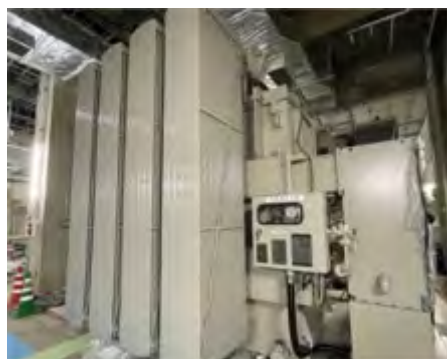
整流器ほか変電設備（東札幌変電所）
