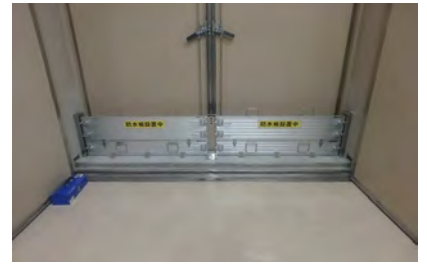
麻生変電所 止水板
