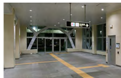
澄川駅 耐震ブレース
