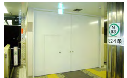
南北線北24条駅ホーム 防火扉
