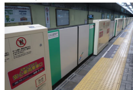
南北線可動式ホーム柵
