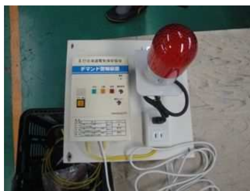
デマンドの警報装置（パトランプ）
