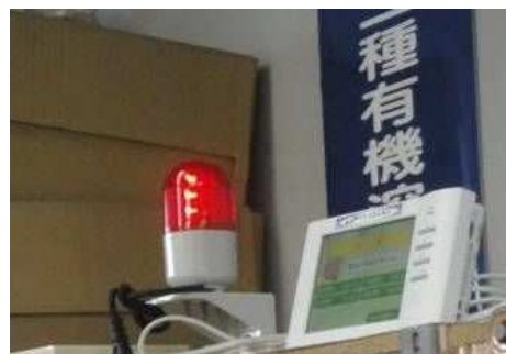
デマンド監視装置と警報装置の設置状況
