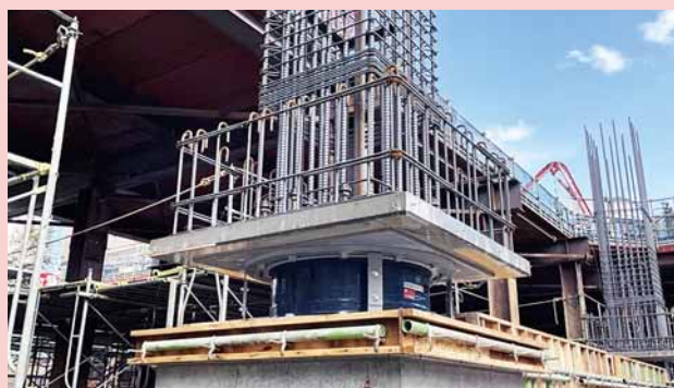
▲新庁舎の免震装置。揺れを吸収するゴム（黒い円柱の部分）を金属の板で挟む構造で、上部の鉄筋は1階の柱になります。
