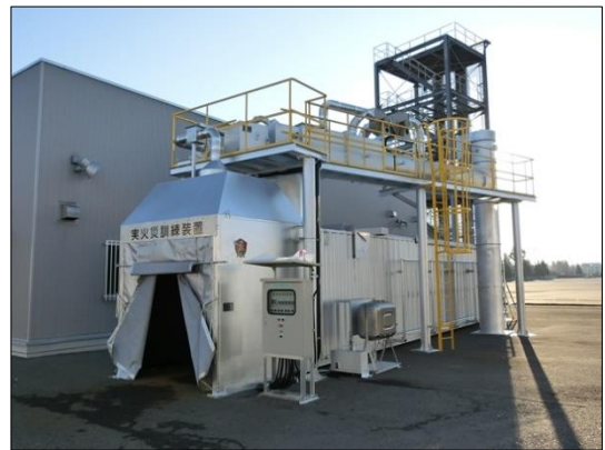
図1 実火災訓練装置（外観・前面）
