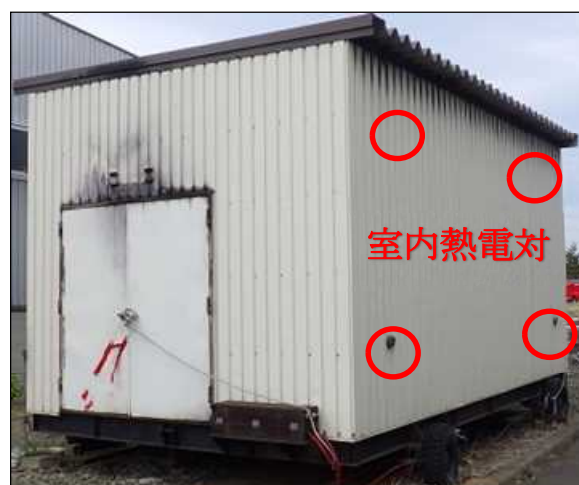
図 4 熱電対設置位置(室内位置：屋外から撮影)
