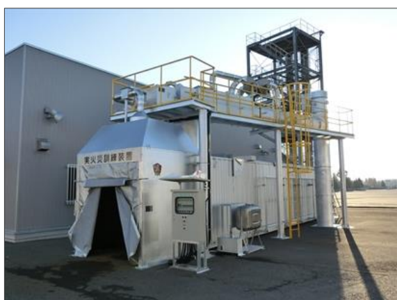
図1 実火災訓練装置（外観・前面）
