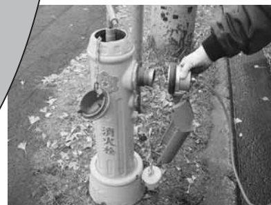
消火栓の放口にふたを接続
