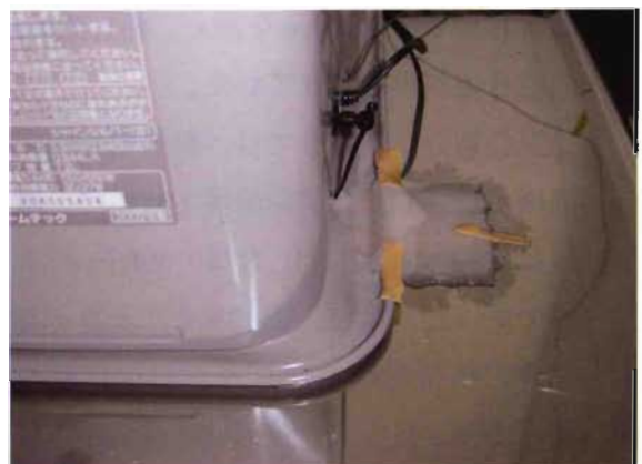
写真8 漏洩時の状況
