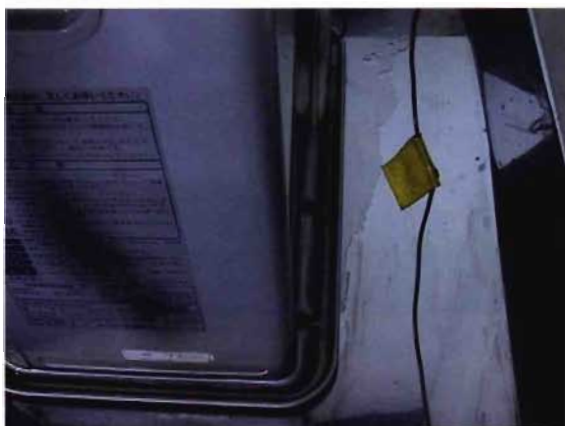
写真10 漏洩時の状況
