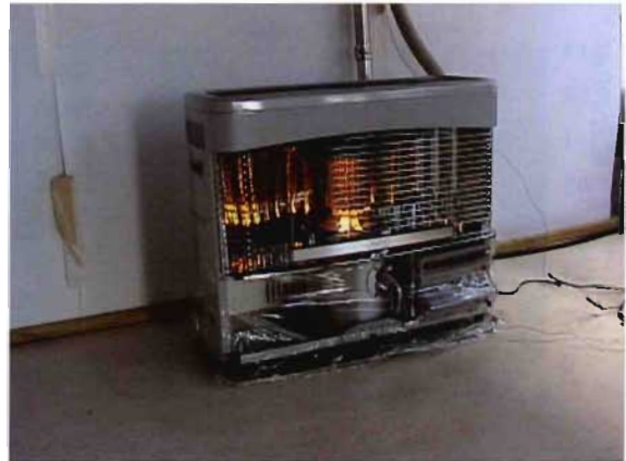
写真14 異常燃焼時の状況
