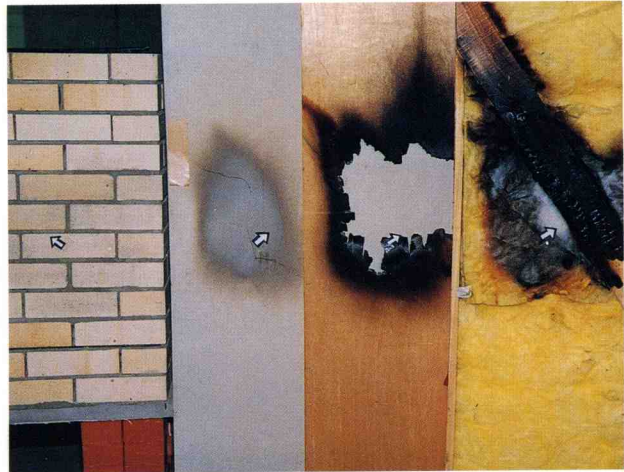
写真 15 壁体各部材の受熱及び焼け状況
