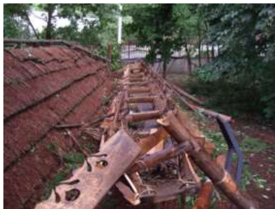
損壊状況①
