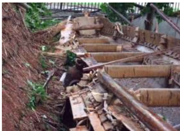
損壊状況②
