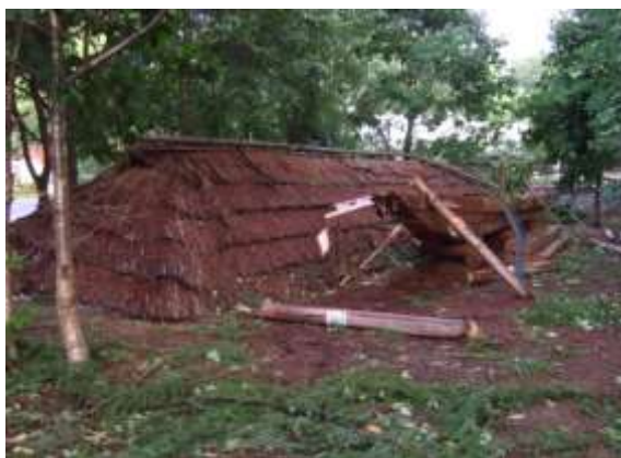
損壊状況③
