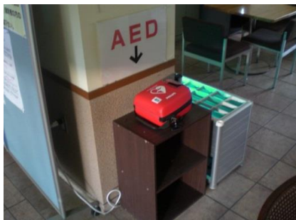
管理事務棟に設置してあるAED
