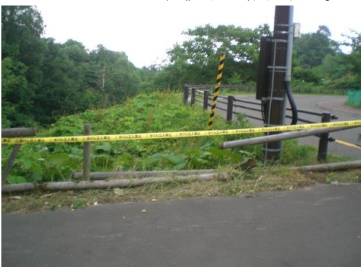
木柵破損状況及び立入禁止処置
