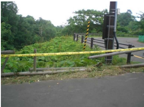
木柵破損状況及び立入禁止処置
