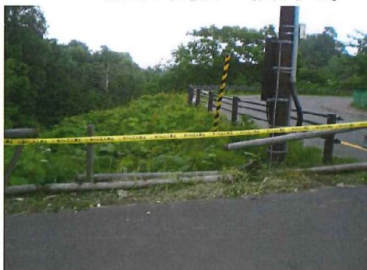
木柵破損状況及び立入禁止処置
