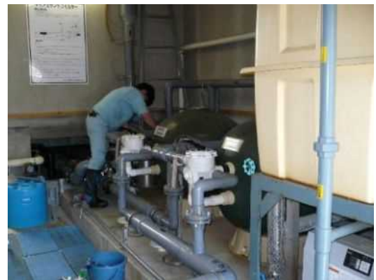
電気施設、機械施設点検講習
