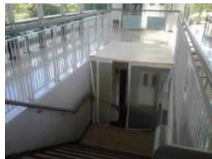
階段からの冷気漏れ対策
