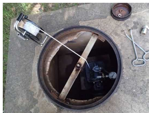
飼育用水取水井戸（水位の測定作業点検）
