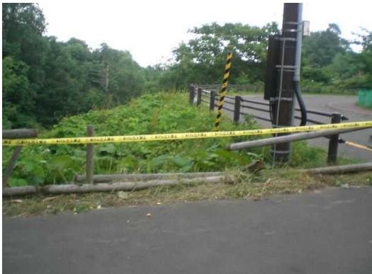
木柵破損状況及び立入禁止処置
