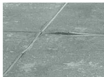
伸縮目地材の変形、欠損
