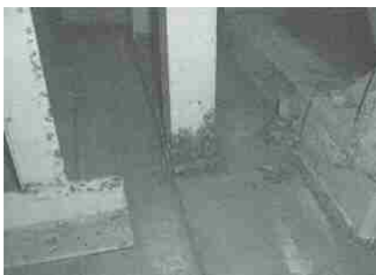
ダクトの支持金物の腐食
