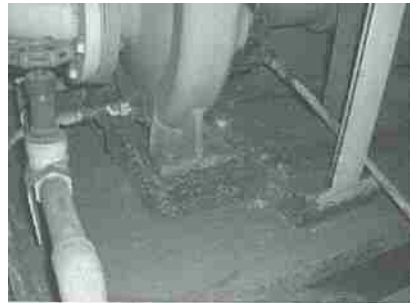
本体固定部の腐食
