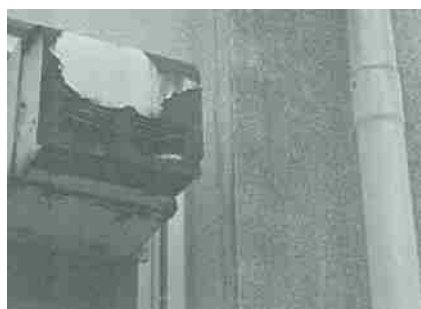
換気口、給気口の腐食
