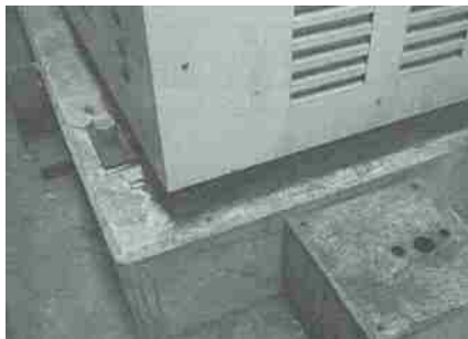
本体固定架台の腐食
