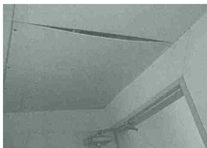
天井等の仕上げ材の著しいずれ
