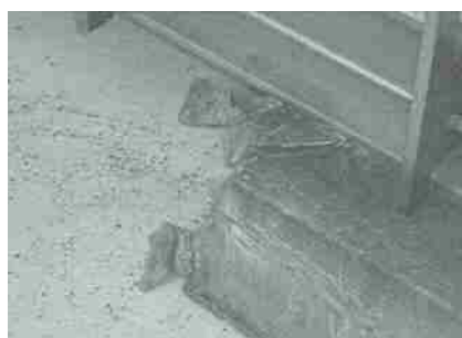
本体固定部コンクリートの割れ
