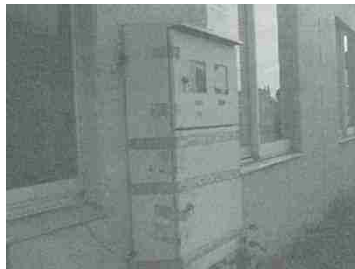
盤の扉開閉部の損傷、変形
