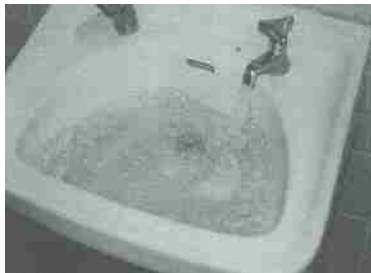
給水器具よりの吐水にさびが混じっている
