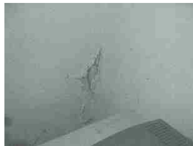
内壁の浮き、はく離
