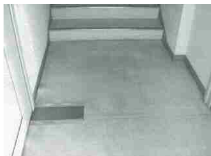
床のたわみによる作動時の支障
