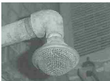
スプリンクラー設備ヘッドの腐食
