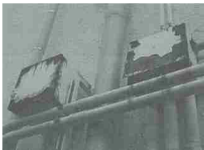
著しい損傷、変形、腐食
