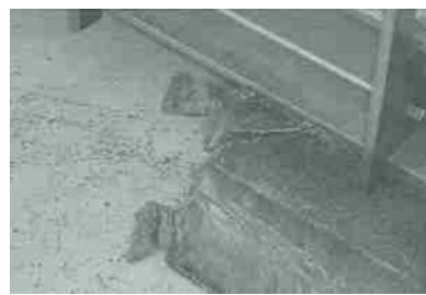
本体固定部のコンクリートの割れ
