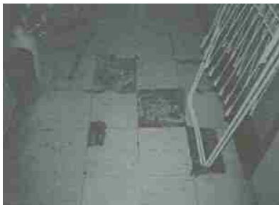
ビニル床タイルの欠損、はく離
