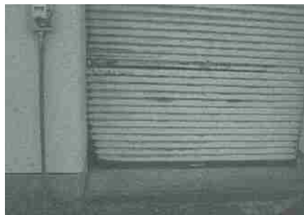
シャッターのさび
