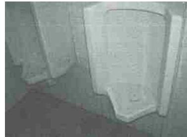
排水器具のつまり
