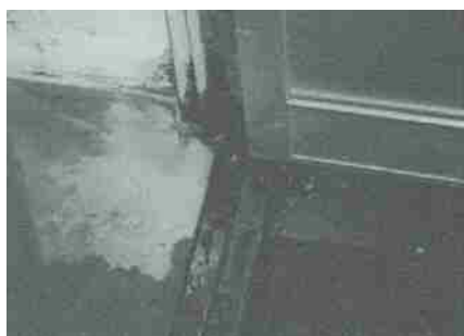
ドアの枠の腐食
