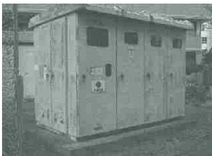
受変電機器キャビネット外板の腐食
