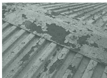
金属製屋根ふき材の腐食
