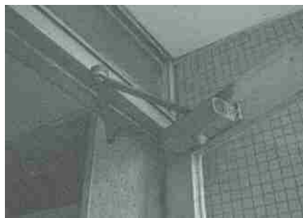
ドアクロザーの腐食
