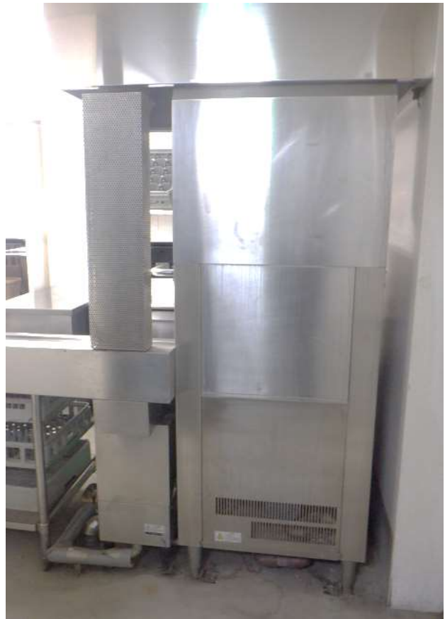
食器洗浄機およびガスブースター背面
