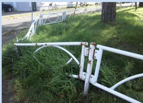
【外柵フェンス（老朽化・破損）】
