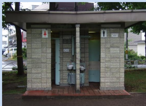
【トイレ（老朽化・バリアフリー未対応）】
