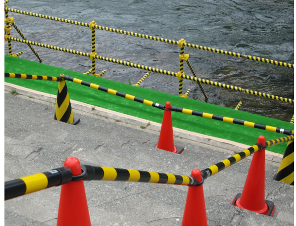
【安全柵、コーン、足場イメージ】
