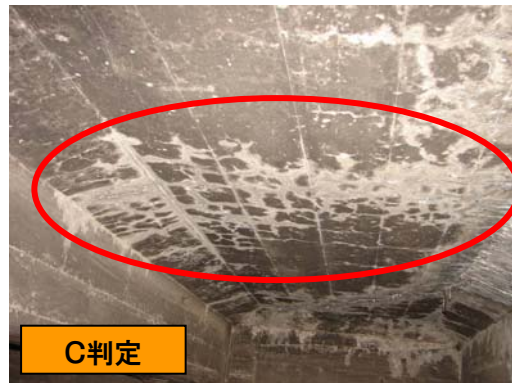
【コンクリート橋の床版】遊離石灰：C判定
