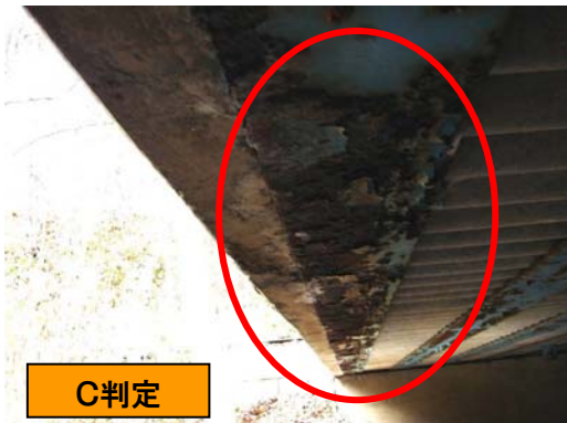
【鋼橋の主桁】腐食：C判定
