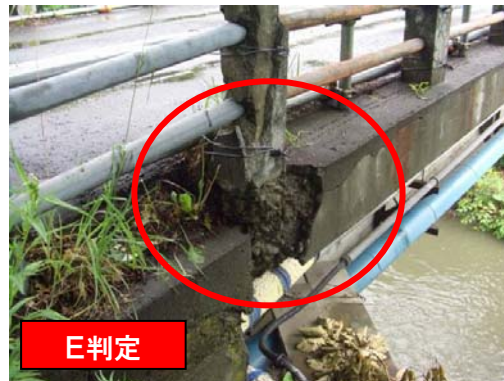
【高欄・地覆】はく離：E判定
