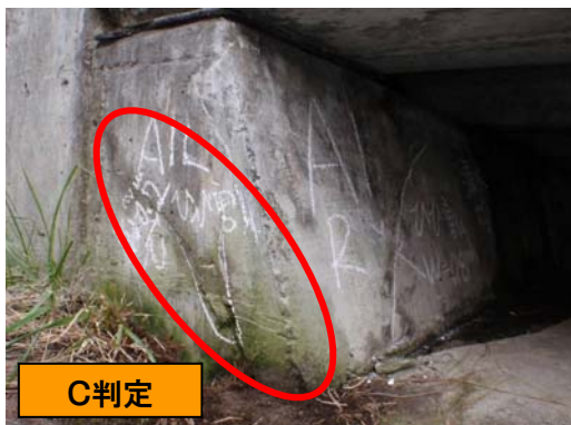
【下部工】ひび割れ：C判定
