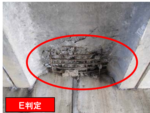
【コンクリート橋の主桁】はく離・鉄筋露出：E判定
