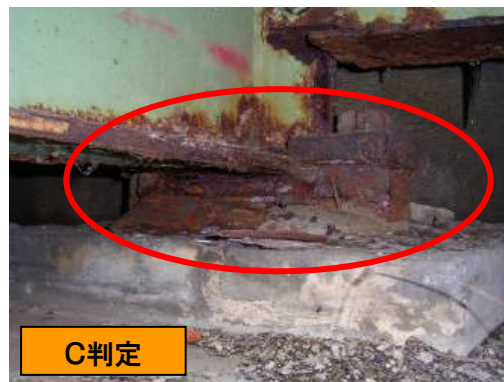
【支承（鋼製）】腐食：C判定
