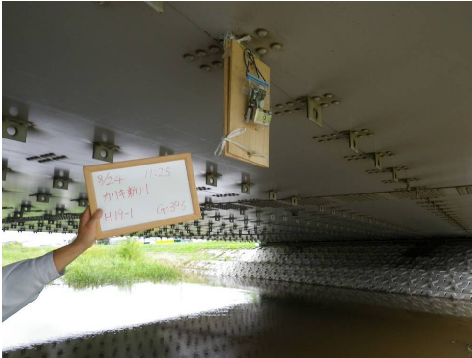
写真 2-3-1 雁来新川における自動撮影装置 (FC) の橋梁への設置状況
