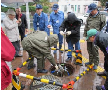
マンホールの中から水圧で給水栓が上昇
