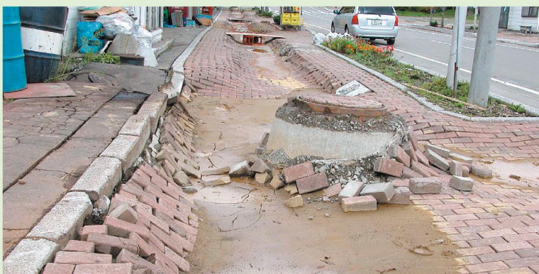
2003年十勝沖地震 写真提供:土木研究所 寒地土木研究所
