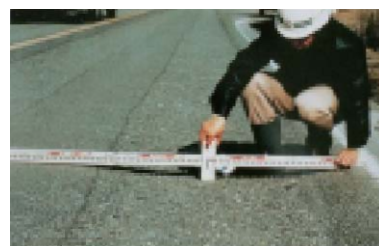
スパイクタイヤによって大きく削り取られた道路面
