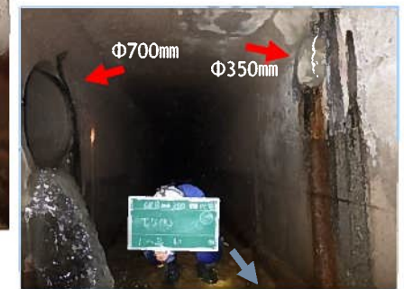
写真② 下水管（雨）接続 土砂の流入痕跡あり
