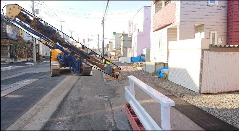
→21号線での削孔作業のイメージ ※削孔機械が道路を占有します
