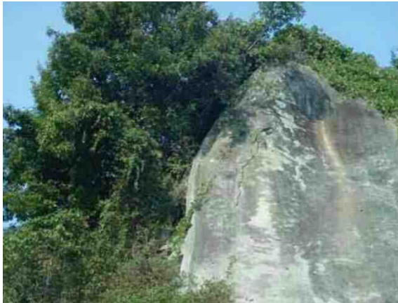
＜対策実施前：モルタル吹付工の劣化＞
