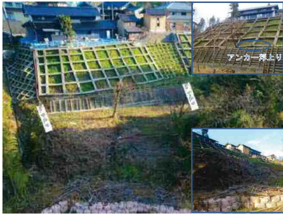
＜対策実施前：アンカー浮上り、斜面崩壊＞
