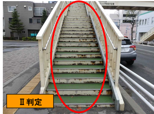
【蹴上げ部】腐食：Ⅱ判定
