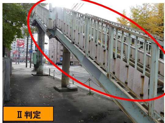
【高欄】腐食：Ⅱ判定
