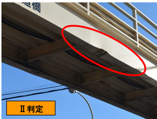
【主桁】腐食(車輛接触)：Ⅱ判定
