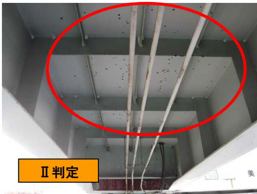
【床版(鋼床版)】腐食：Ⅱ判定
