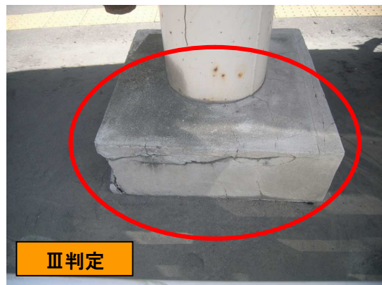
【根巻きコンクリート】ひび割れ：Ⅲ判定
