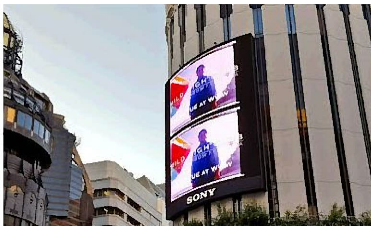
(壁面に設置されたデジタルサイネージ)
