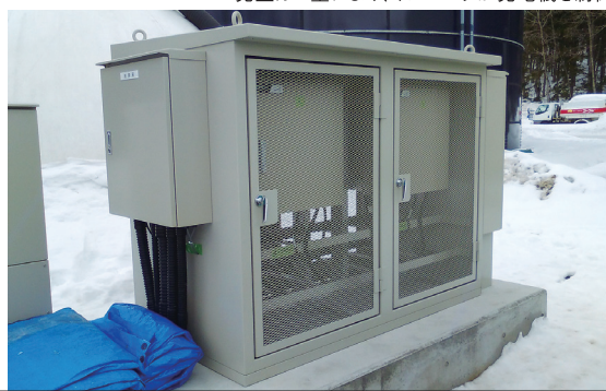
発生ガス量により、インバータが発電機を制御
