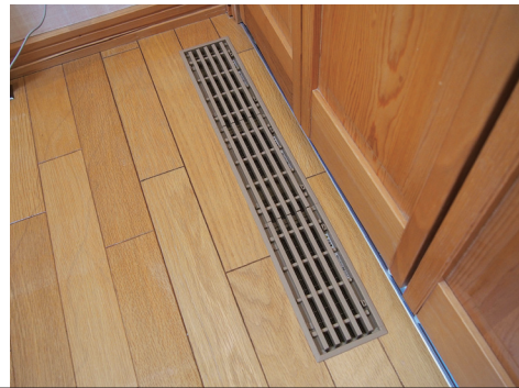
床のガラリから温風を室内へ供給
