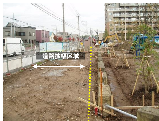
写真右：施工中 (2013年、北東方向を望む) ※いずれの写真についても、左側に写る道路が「新琴似第1横通」である。
