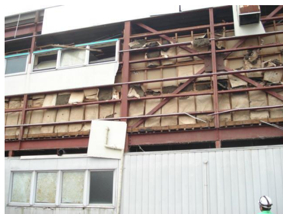
石綿露出状況の調査(目視)
