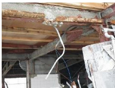
建物に残存した吹付け材
