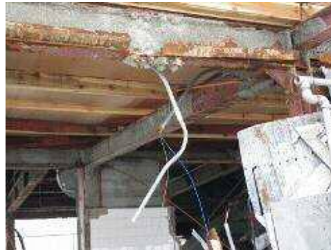
建物に残存した吹付け材
