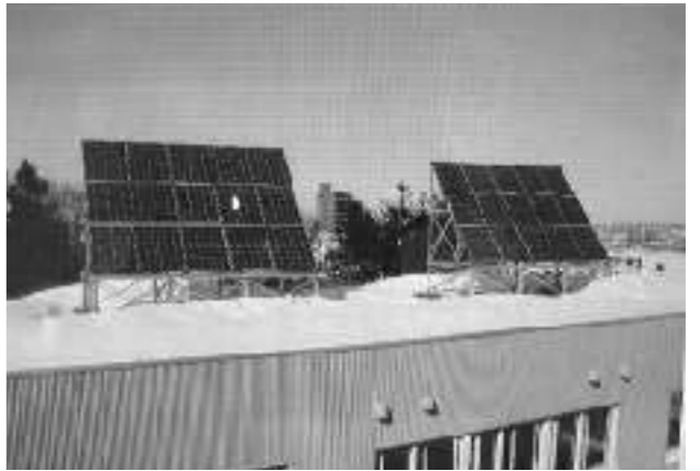
正面から見たソーラーパネル外観
