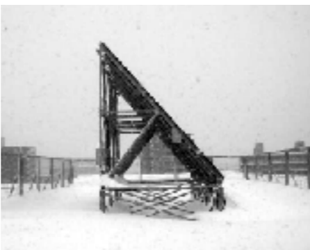
屋上に設置されたソーラーパネル
