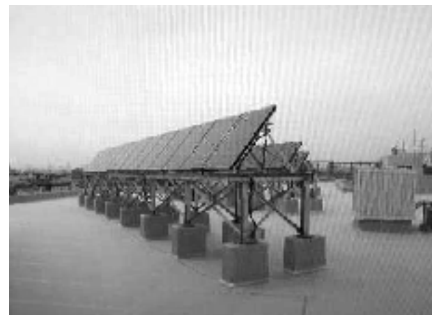
屋上のソーラーシステム
