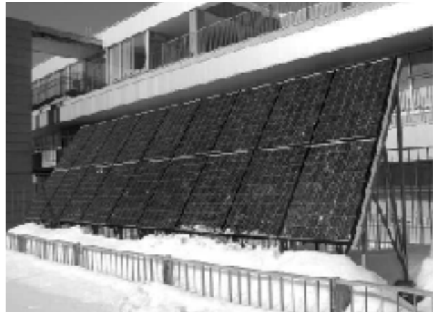
屋上に設置されたソーラーパネル
