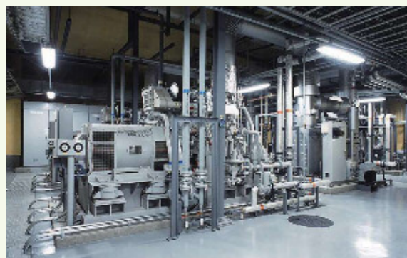
コージェネレーションシステム
