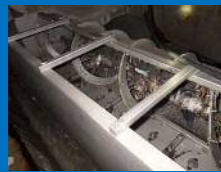
機械式スクリーン 設置箇所：17箇所
