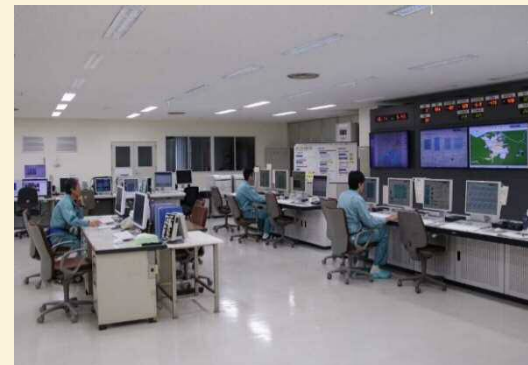
OJT(水再生プラザの運転管理)
