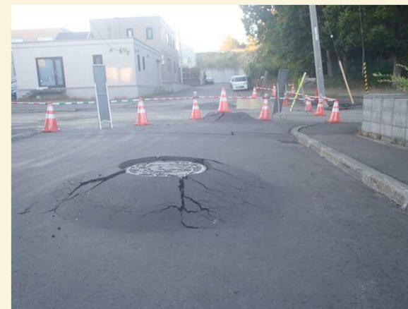
液状化の状況 (埋設状況を踏まえた耐震化)
