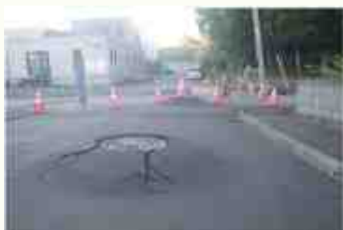
マンホールの浮上
