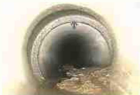
管路のつなぎ目のずれ
