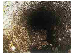
【油が原因による下水道管の閉塞状況】
