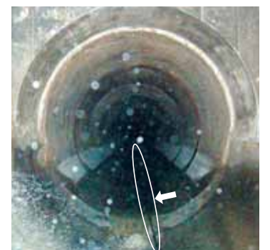
下水道管内の光ファイバー(ケーブル)
